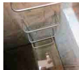
校舎地下の貯水タンク
