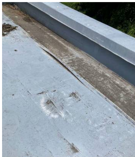
《みさき小本校舎 屋上防水劣化》
