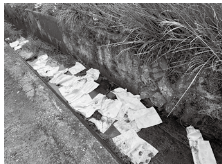
油吸着マットで流出した油を回収
