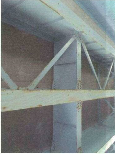
評価 3 (部分的にさびが見られる。ここでのさびの発生割合約 6%)
