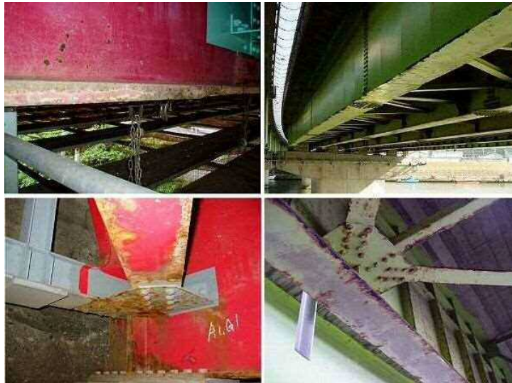
鋼橋塗膜における部材端部の腐食事例
