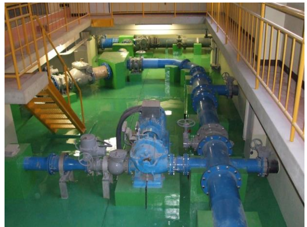
豊丘ポンプ場内部
