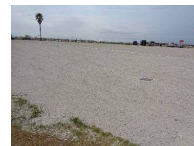
未舗装で水はけの悪い駐車場
