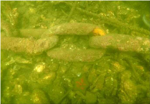
老朽化した浮棧橋のチェーン
