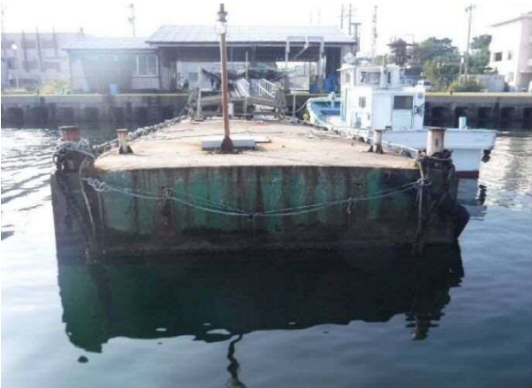
老朽化した18号浮棧橋の浮体
