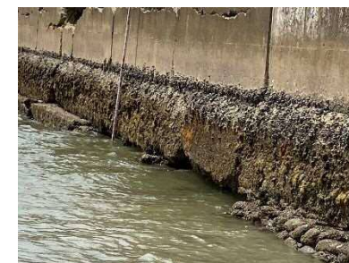
洗掘により穴が開いた突堤
