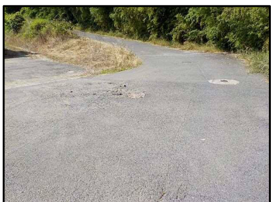
ヒビ割れの目立つ農道の再整備
