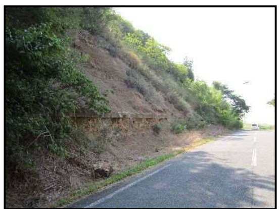
落石のおそれがある法面整備
