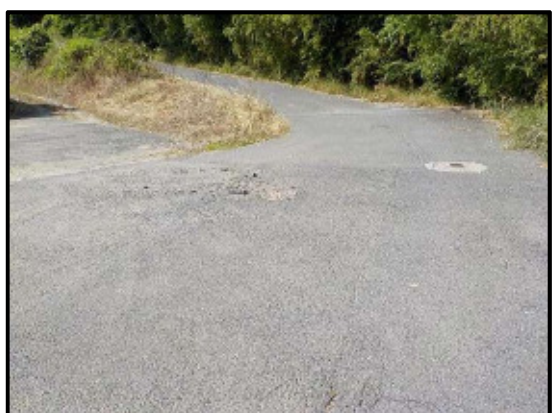
ヒビ割れの目立つ農道の再整備
