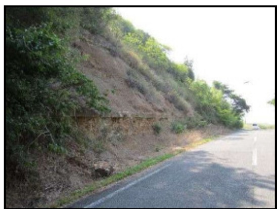
落石のおそれがある法面整備
