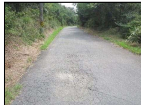
ヒビ割れの目立つ農道の再整備
