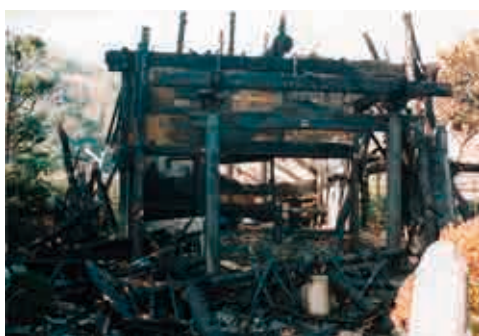
弘法堂の被害状況
